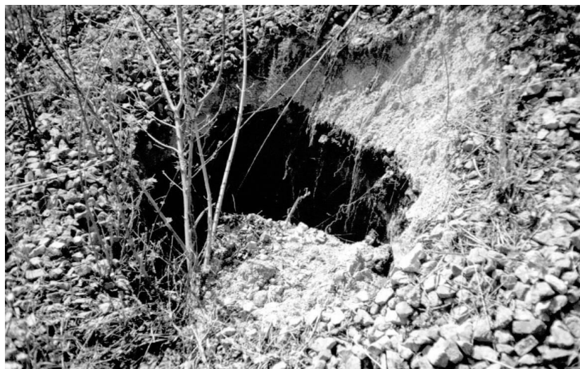
Рис. 1. Общий вид участка железнодорожной магистрали в Алтайском крае ( а ); воронка провала грунта в откосе насыпи ( б )
